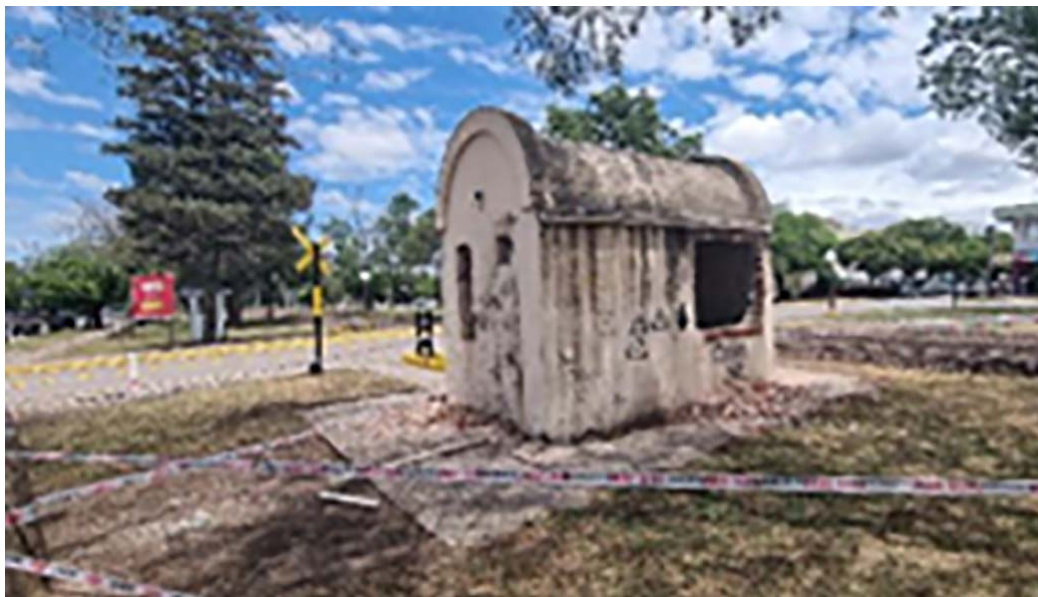
Imagen N° 13: Garita de paso a nivel. Calles Chile y Av. Juan B. Justo Estado de conservación: Demolido Fotografía del autor. Fecha de toma: 2 de noviembre de 2021
