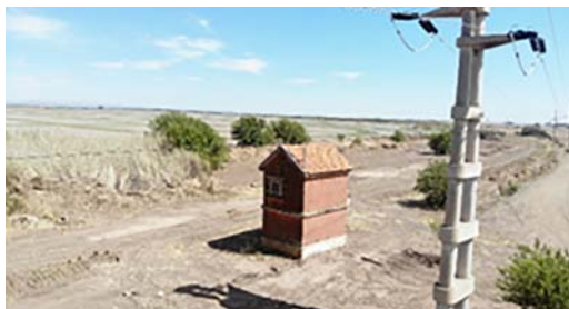
Imagen N° 27: Cabina de señales, vista trasera. Parador ferroviario Km. 784. Sinsacate. Estado de conservación: Malo/Abandonado. Fotografía del autor. Fecha de toma: 22 de noviembre de 2022
