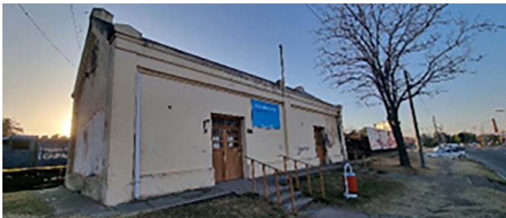
Imagen N° 10: Inmueble ferroviario. Actualmente oficinas del Ministerio de Trabajo. Estado de conservación: Malo. Fotografía del autor. Fecha de toma: 14 de julio de 2022
